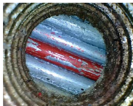
固定金具内のケーブル状況
