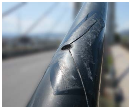
保護管の損傷
